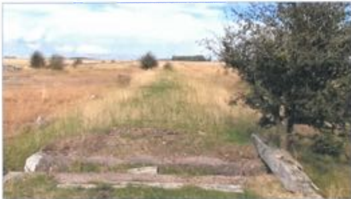
Figur 2. En öppen trumma leder vatten genom banvallen i södra delen av sträcka 6.
