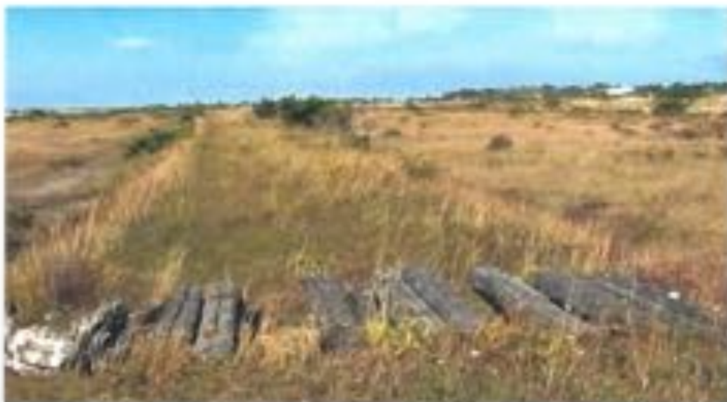
Figur 12. En öppen trumma inom delsträcka 15 täckt med sliprar för att komma över, denna trumma är av god status och det ska utredas vidare om den går att bevara.
